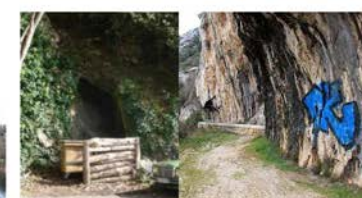
Stockage des déchets et graffitis aux abords des tunnels
